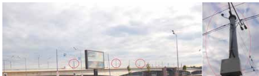
Рисунок 6. ГНСС оборудование на мосту Александра Невского
